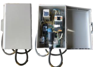
100V夜間給水盤
